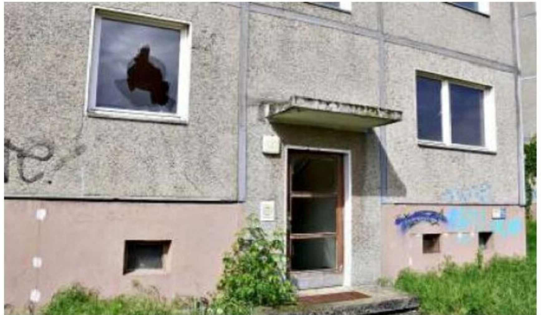
Die Scheiben der Eingangstür des leerstehenden Plattenbaus in Rothensee sind eingeschlagen. Ein Zutritt ist jederzeit möglich.
