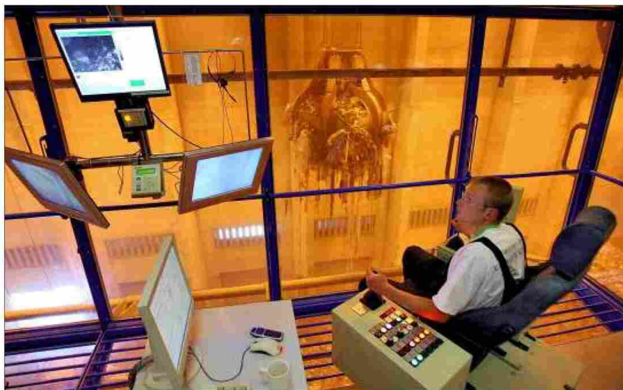
Ein Mitarbeiter steuert im Müllheizkraftwerk einen riesigen Greifer, der Müll vom Lager zum Brennofen befördert. Aktuell werden 650 000 Tonnen Müll jährlich in Wärme umgewandelt. Archivfoto: Peter Förster/dpa
