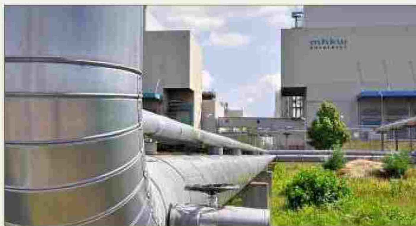
Eine Fernwärmeleitung der Städtischen Werke Magdeburg und das Müllheizkraftwerk Rothensee. Foto: Martin Rieß
