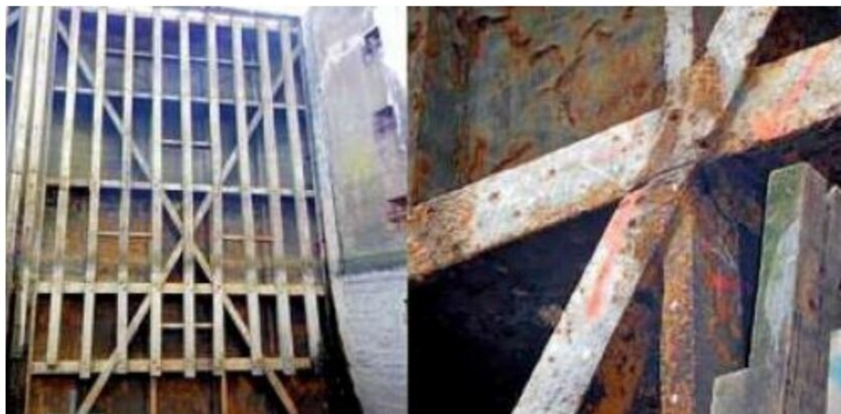
Korrosion und Risse im Stemmtor erfordern den Austausch der Schleusentore.
