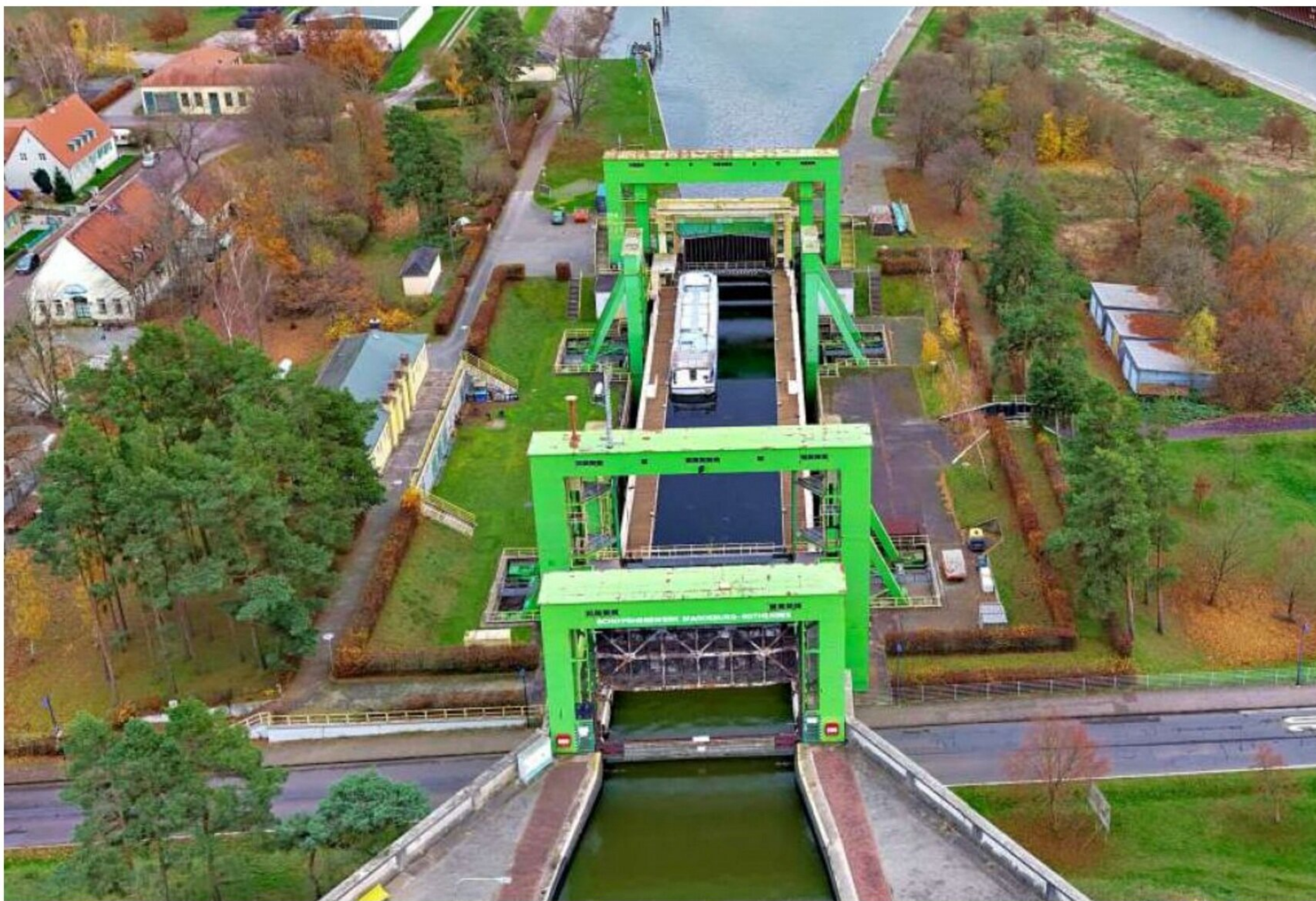
Die Landeshauptstadt Magdeburg hat das Schiffshebewerk 2012 von der Bundesrepublik Deutschland übernommen. Das Bauwerk ist mittlerweile so sehr verschlissen, dass es für viel Geld saniert werden muss.
