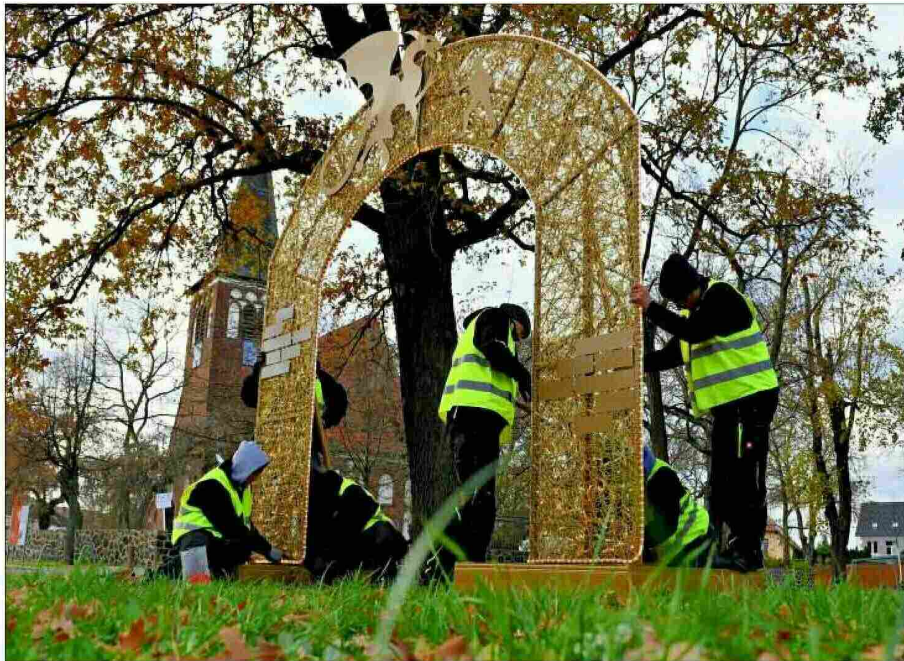
Mitarbeiter der Firma Multidekor installieren den Lindwurm-Lichtbogen auf dem Akazienplatz in Rothensee. Über eine Spendenaktion wurde das Geld für das neue Element gesammelt. Ab Sonnabend soll es dann leuchten.
